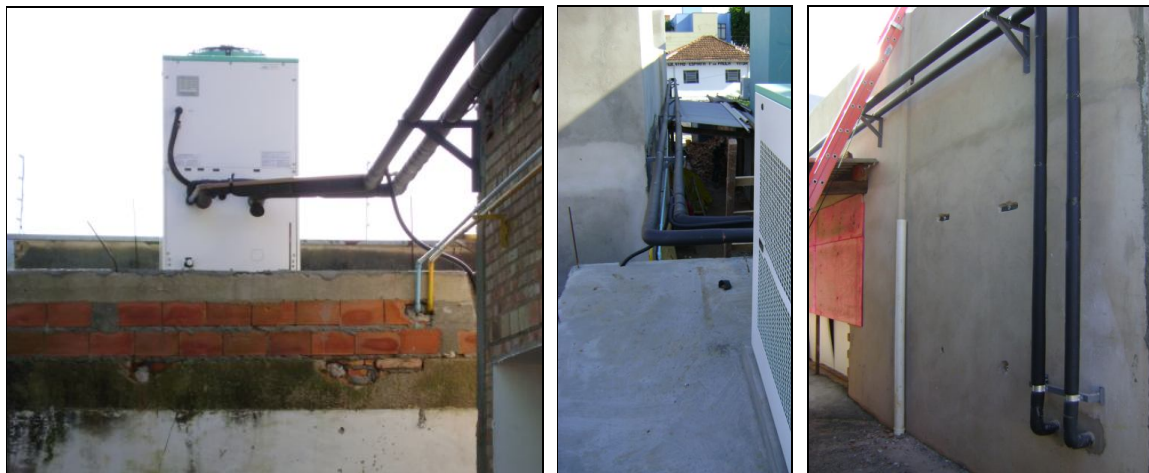
Exemplo de um Chiller instalado e tubulação chegando na sala técnica
