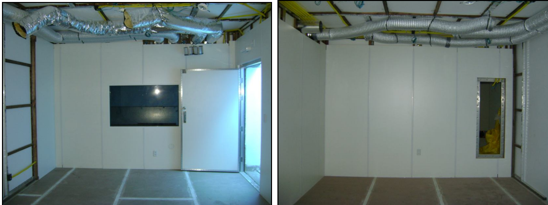
Detalhes da tubulação de insuflamento e retorno dentro da Blindagem de RF
