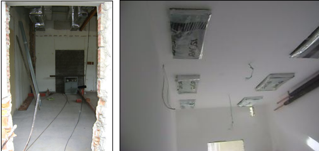
Vista do teto da sala técnica, insulfamento e retorno nas laterais da sala É importante reforçar que o ar quente sai sobre os gabinetes, portanto não insulfar sobre eles.
