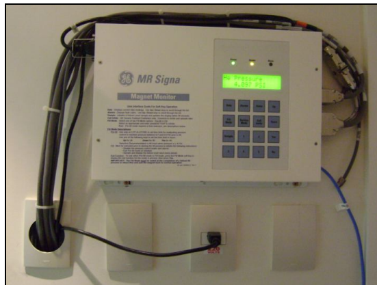
Instalado na sala de comando
